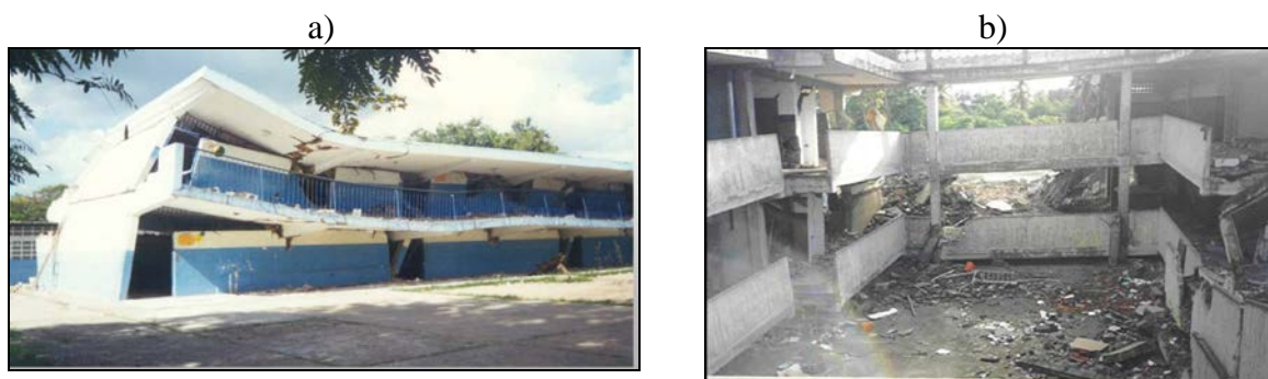
Figura 1.2. Escuelas colapsadas debido al sismo de Cariaco de 1997; a) Escuela Valentín Valiente (Antiguo I); b) Liceo Raimundo Martínez Centeno (Cajetón).
